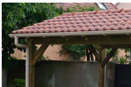
Gouttière en PVC
